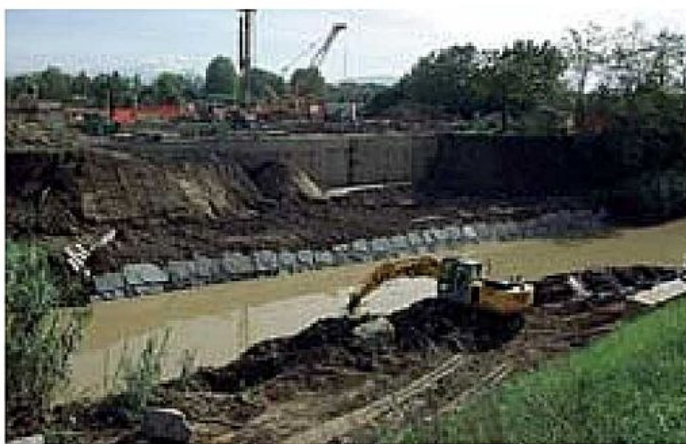
Il cantiere I lavori per far passare il tubone sotto la Greve
